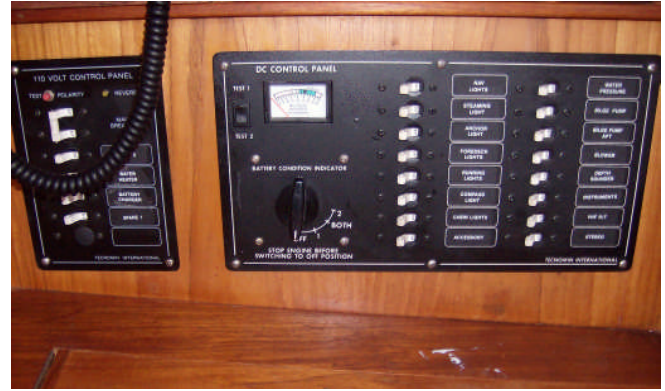
120-volt AC panel / 12-volt DC panel
