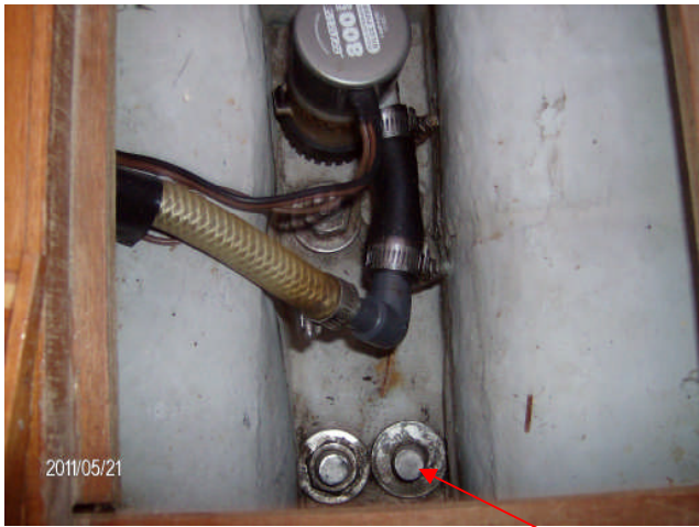
B1/1 keel bolt missing
