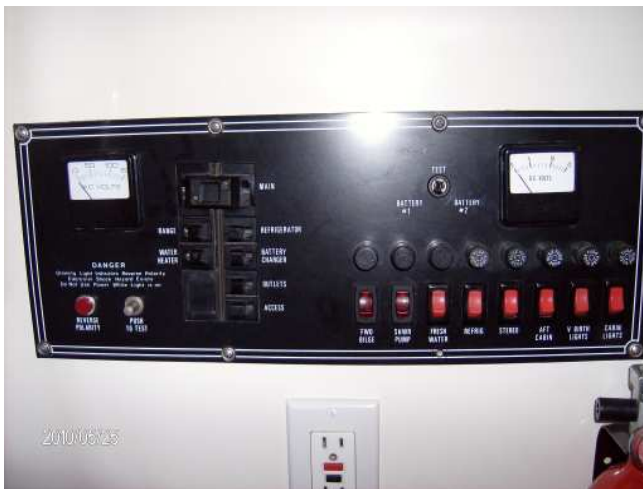
120 volt AC / 12 volt DC panel
